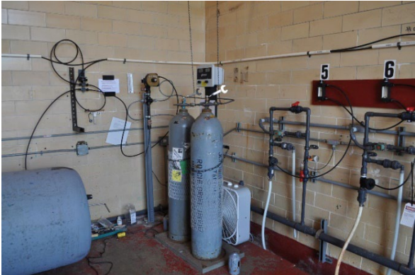
1 Ton Chlorine Cylinder
